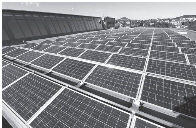
Foto: PV-Fläche auf der Stauferlandhalle, Salach (Foto: Archiv BEG)
